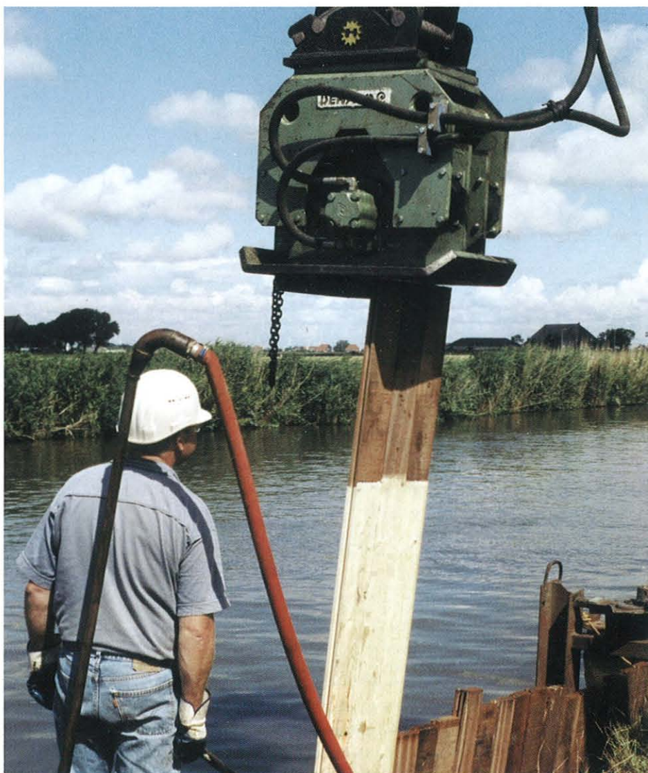
Figuur 3: Plaatsing damwand met boven de waterlijn tropisch hardhout en daaronder Europees naaldhout (foto: Van Swaay Harlingen BV)
